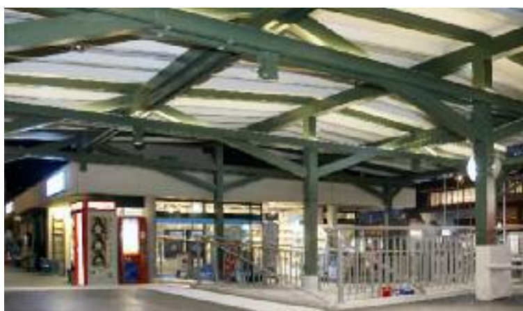
Bild 4 Die LIG Linear Light Module zur indirekten Deckenbeleuchtung werden nur alle 12 m mit Energie versorgt. Dies bei einer Leistung von 8W/m und einer warmen Lichtfarbe von 2700 K.
